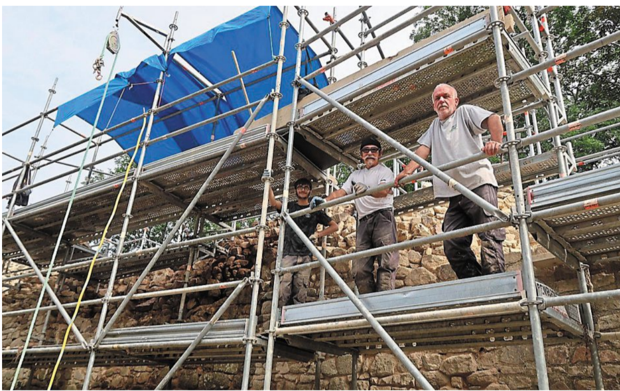
Alexandre, salarié du chantier d'insertion ; Franck Treillard, maçon bâti ancien et patrimoine et Jocelyn Humeau, chef d'équipe de restauration mesurent le travail titanesque accompli.
